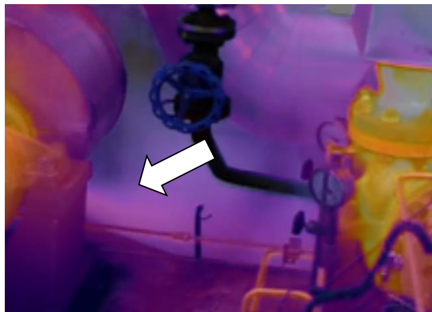
Obr. 34) Termografické zobrazení uniku plynu
