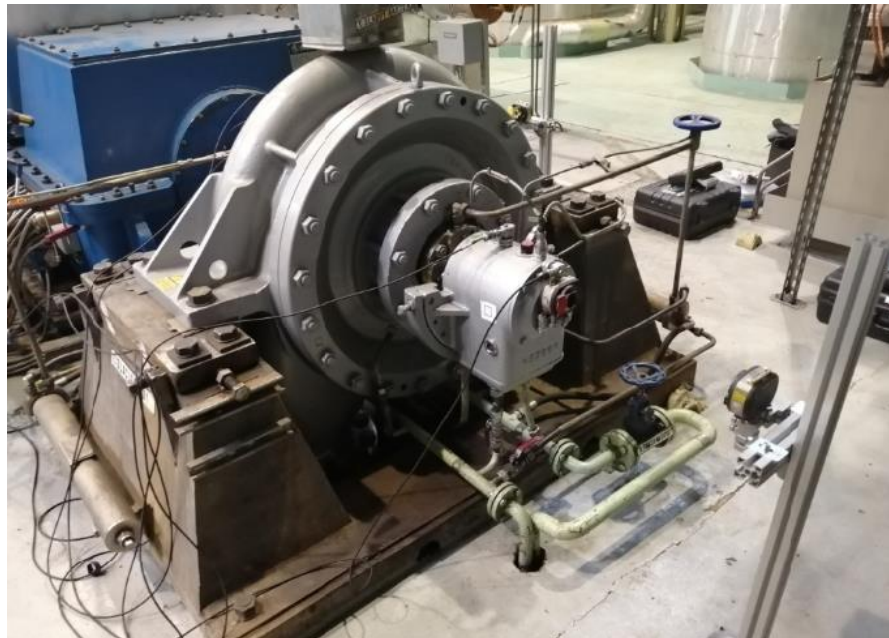
Obr. 86) Čerpadlo s hydrodynamickou převodovkou poháněné turbínou
