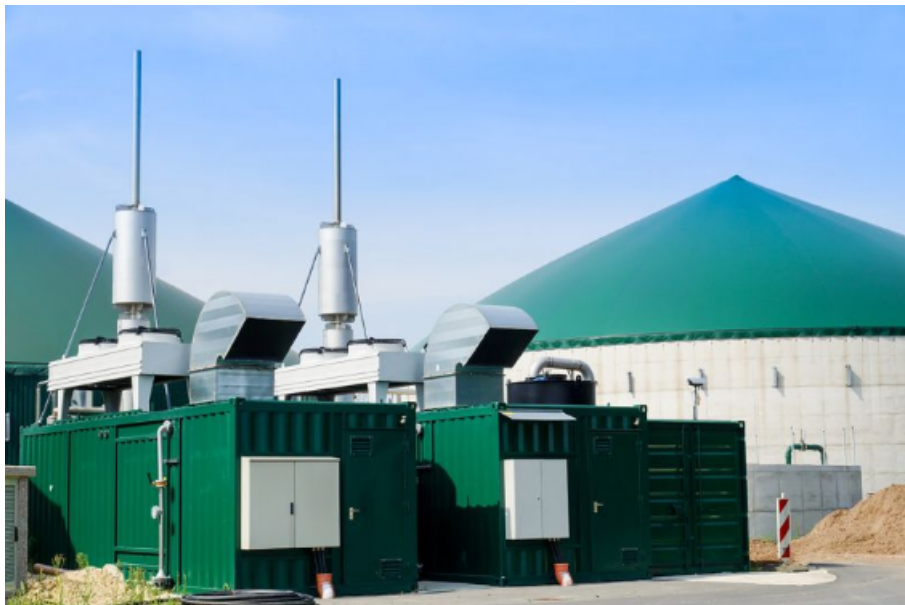
Obrázek 3.2: Kogenerační jednotky v areálu bioplynové stanice [6]
