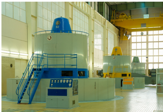
Obrázek 4.19: Strojovna vodní elektrárny Orlík [6]
