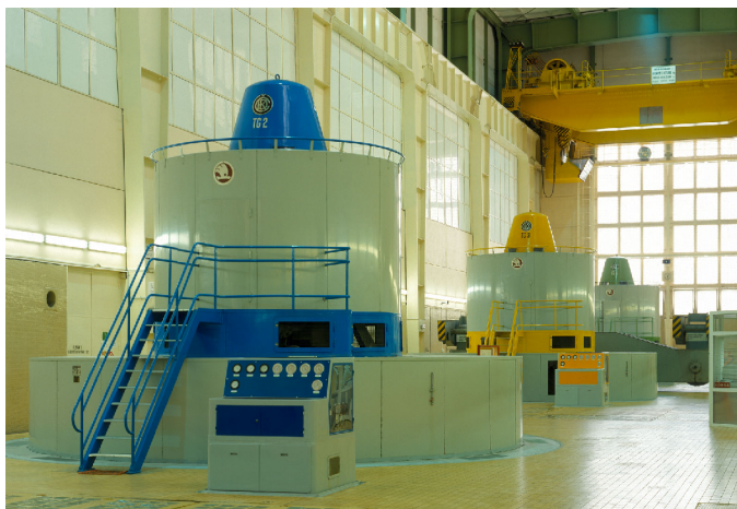
Obrázek 4.19: Strojovna vodní elektrárny Orlík [6]
