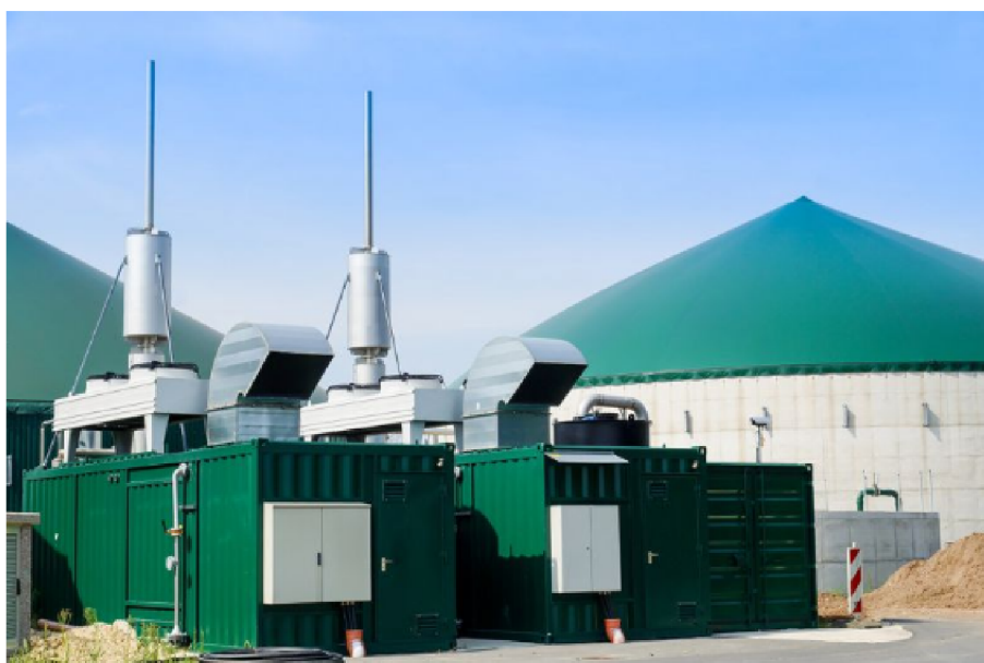
Obrázek 3.2: Kogenerační jednotky v areálu bioplynové stanice [6]
