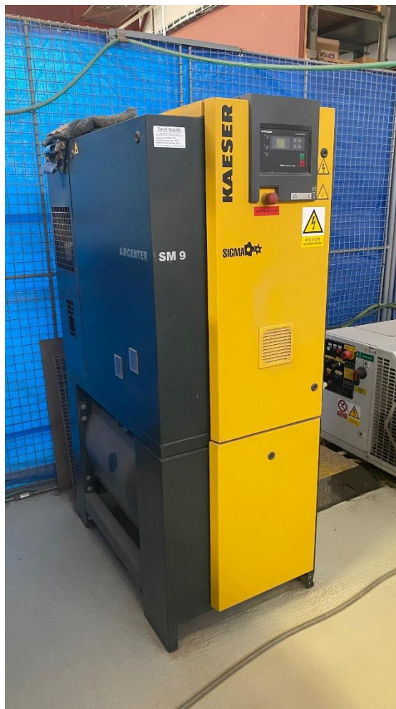
Obrázek 16 - Kompresor Kaeser SM 9, [zdroj autor]
