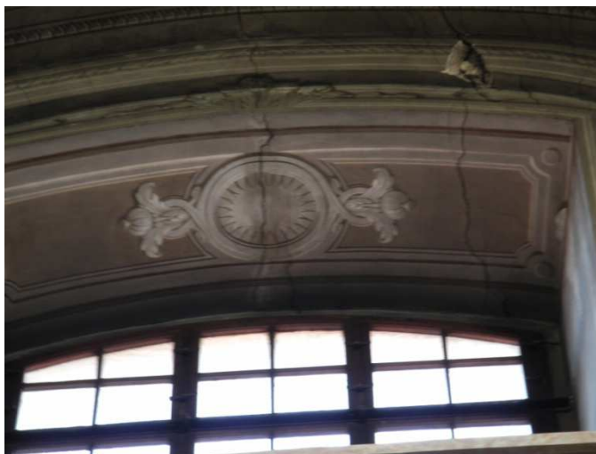
Obr. 5 Trhliny ve zdivu severní stěny
