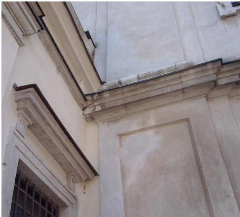
Obr. 18 Trhlina mezi hlavním vchodem a lodí kostela
