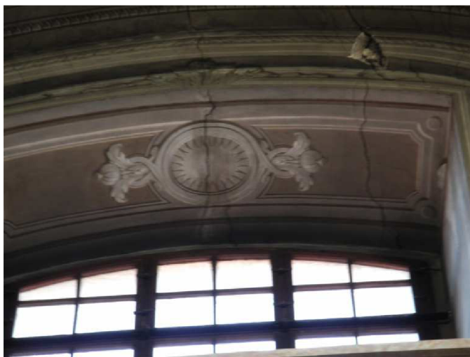
Obr. 5 Trhliny ve zdivu severní stěny
