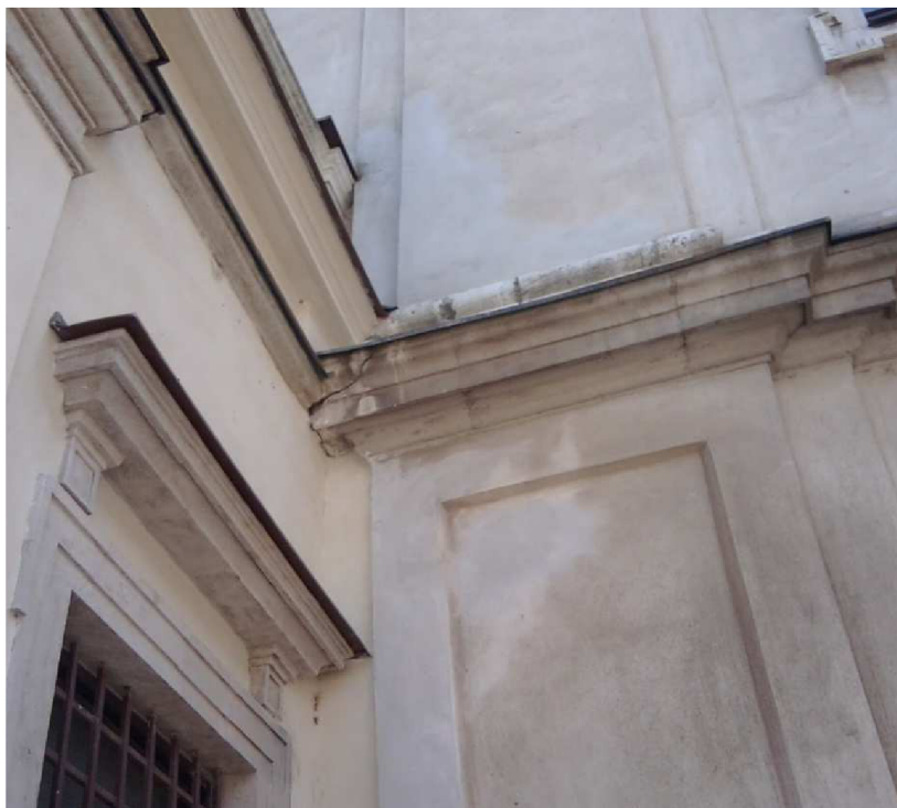
Obr. 18 Trhlina mezi hlavním vchodem a lodí kostela
