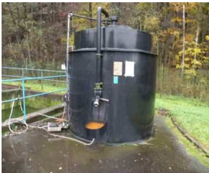
Obrázek č. 7 - Dávkovací zařízení s nádrží polymeru na ČOV Nový Bor
