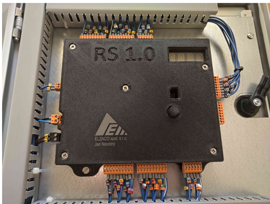
Obr. 8.26: Řídicí systém umístěný v testovacím rozvaděči
