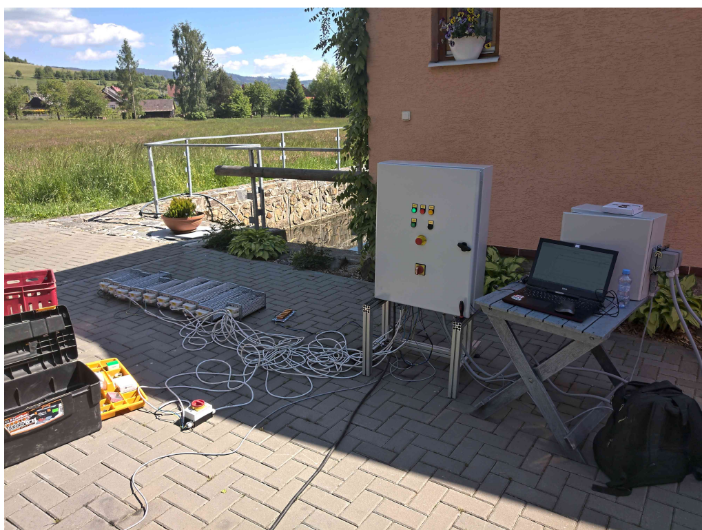
Obr. 11.10: Rozvaděč řízení na vybrané lokalitě
