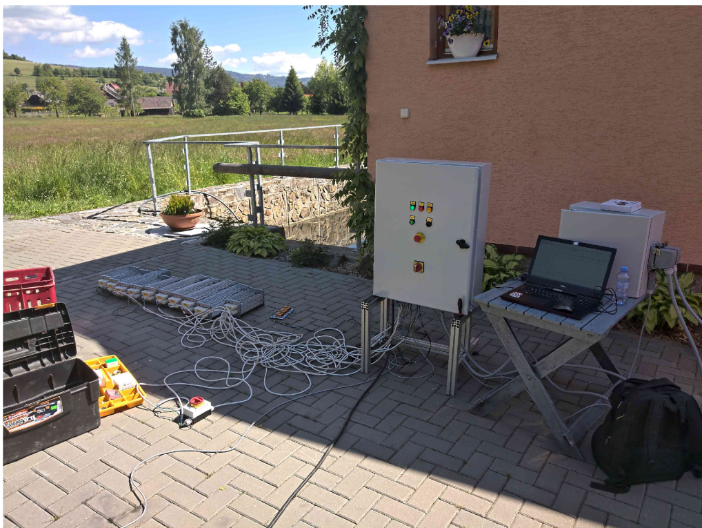
Obr. 11.10: Rozvaděč řízení na vybrané lokalitě
