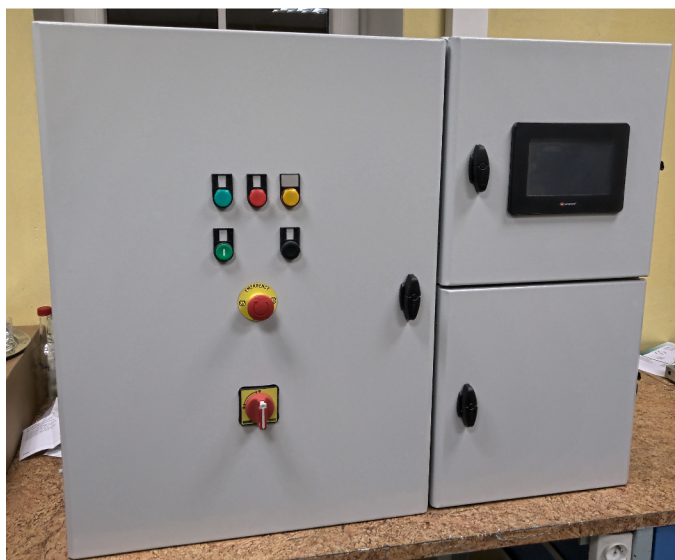
Obr. 5.2: Sestava vyrobených rozvaděčů
