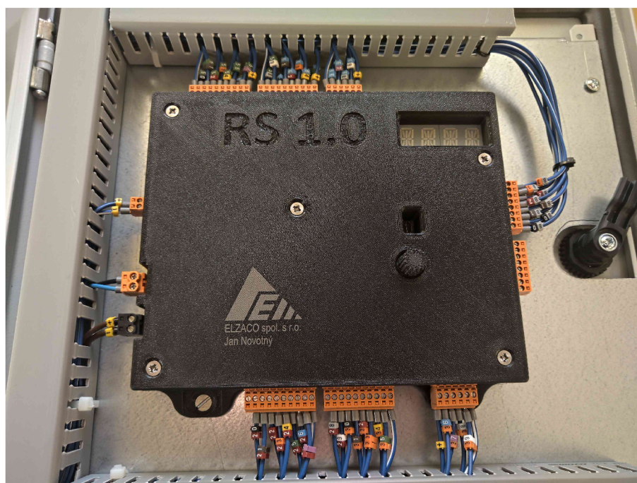
Obr. 8.26: Řídicí systém umístěný v testovacím rozvaděči
