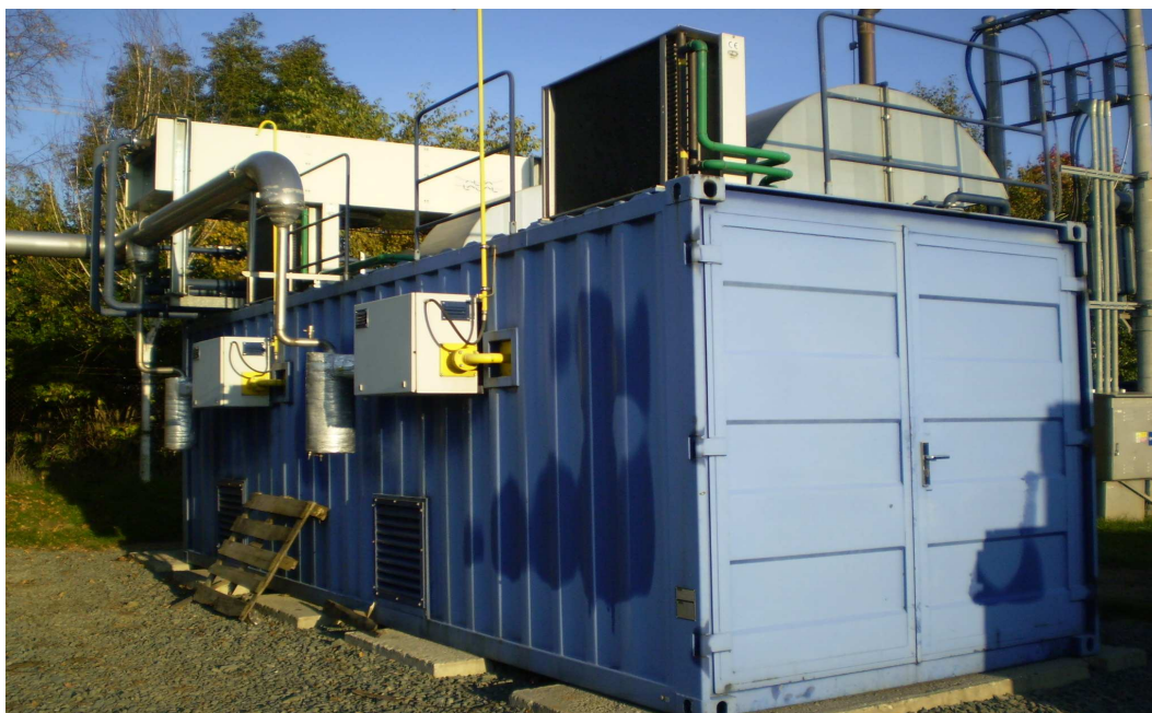
Obr. 1 - Kogenerační jednotka na skládce v Medlově 39
