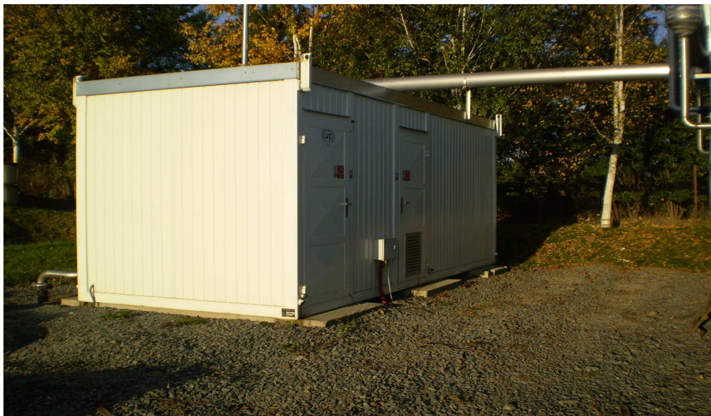
Obr. 2 - Čerpací stanice na skládce v Medlově 50
