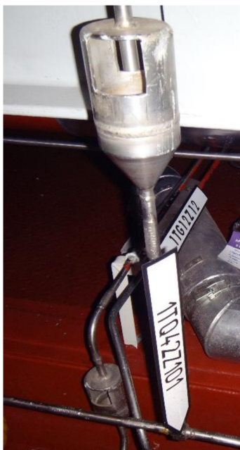
Obr. 12 Revizní průtočná nádržka [2]
