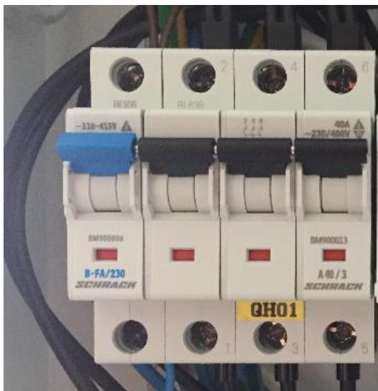
Obrázek 13: Vyrážecí spoušť u hlavního vypínače (pořízeno v laboratoři UEEN)
