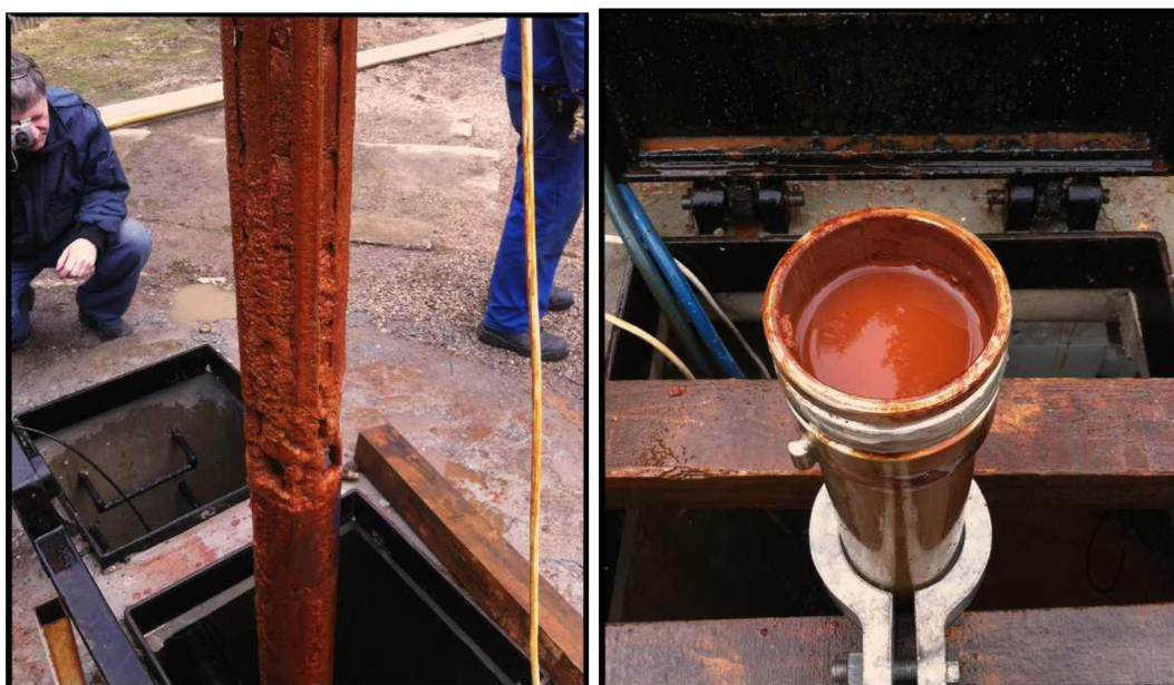
Obrázek 9. Kolmatující usazeniny v čerpací koloně (Severočeské vodovody a kanalizace, a.s.)
