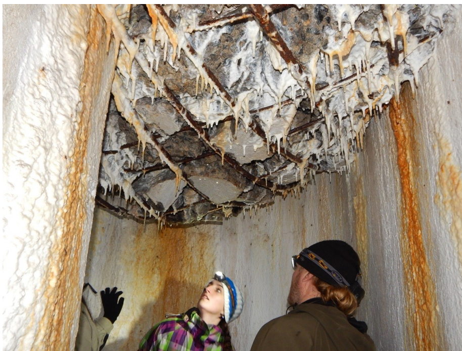
Obr.č.42: Kontrola polorozpadlého stropu v bukru 2016.
