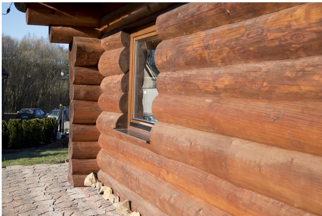
Obrázek 7 - vnější stěna srubového domu vykazující známky vybledlé barvy
