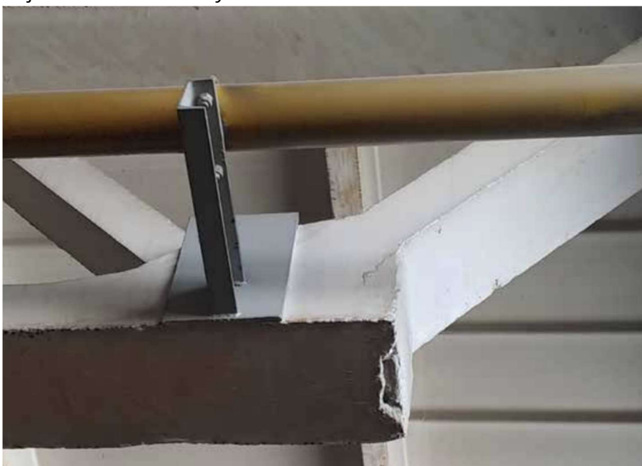
Obr. 13, Nesprávné kotvení instalací [3]
