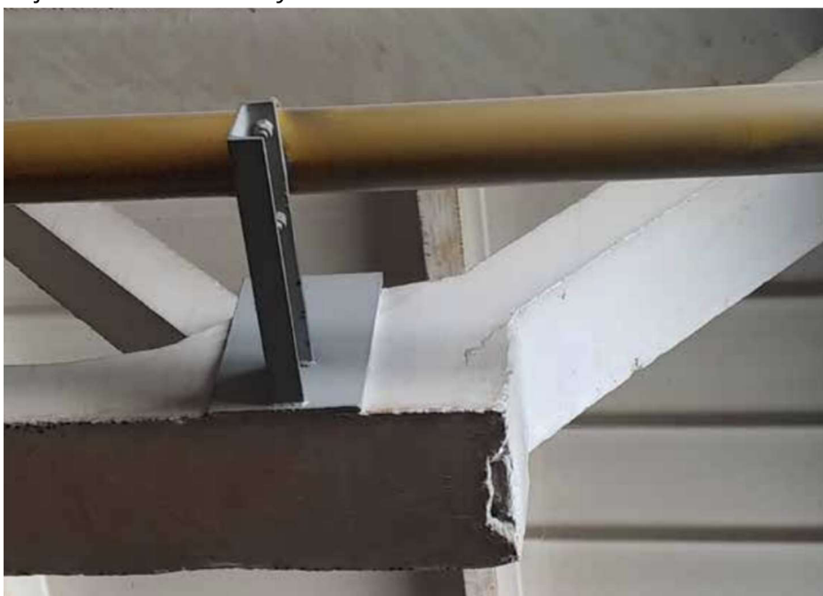
Obr. 13, Nesprávné kotvení instalací [3]
