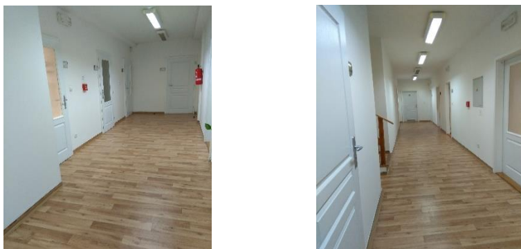
Obrázek 1 Chodba kanceláří společnosti bez označení únikového východu
