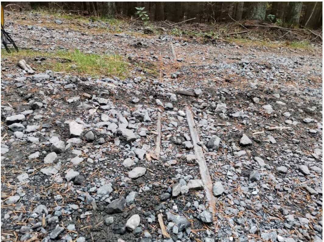
Obrázek č. 41 - Zanesená ocelová svodnice vody na KO418-1
