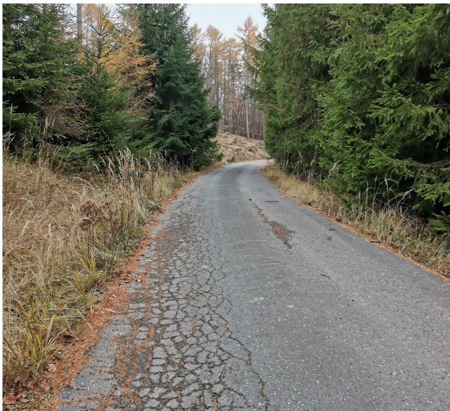
Obrázek č. 38 - Páteční lesní cesta KO401 – síťové trhliny
