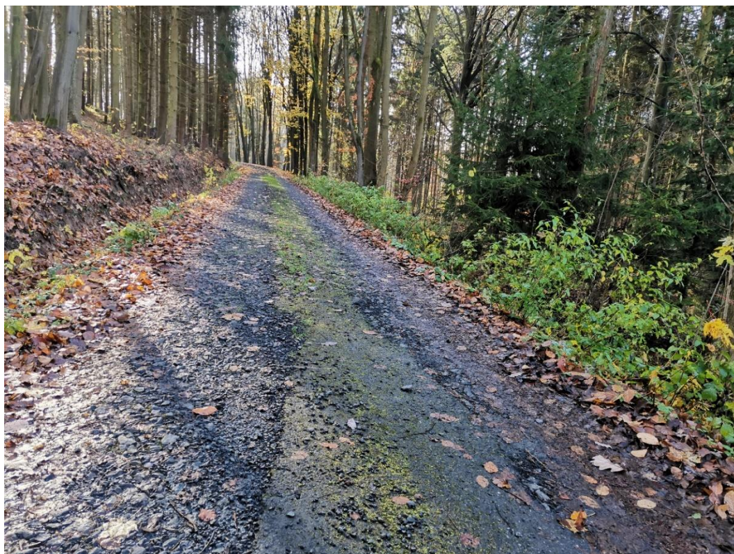
Obrázek č. 37 - Lesní cesta KO402 – narušení krytu vozovky
