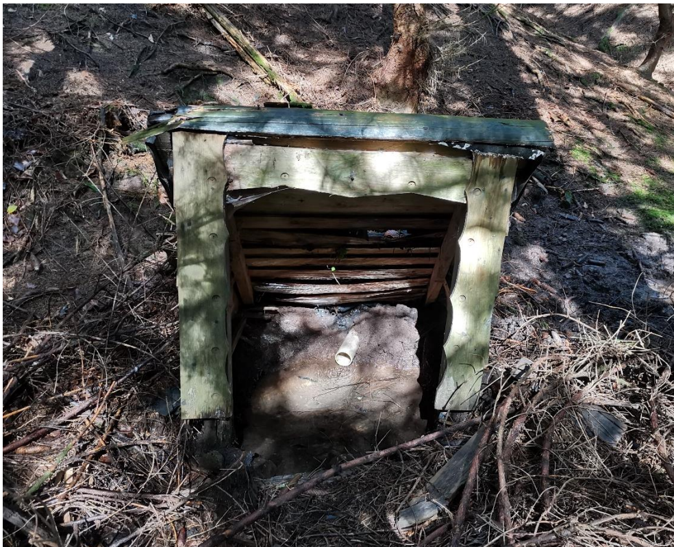
Obrázek č. 51 - Studánka poškozená
