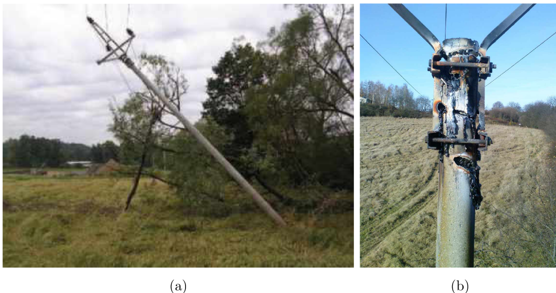
Obr. 1.7: Reálné ZS: (a) vznik ZS pádem stromu na vedení a (b) destruktivní následky ZS přes konzolu a sloup vedení. Převzato z [17] a [18].
