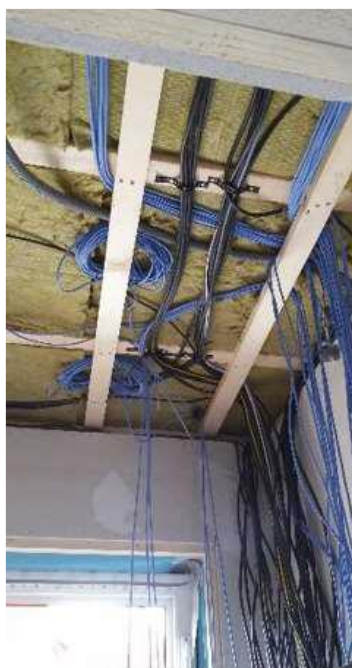
Obr. 11 Instalace teplotně vlhkostních senzorů do podhledu stropní konstrukce (Projekt TH202079)
