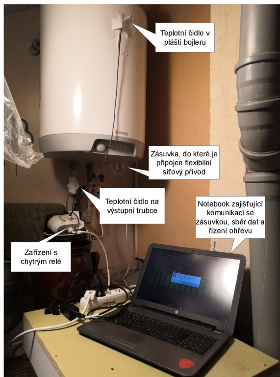
Obrázek 5.4: Instalace zařízení pro sběr dat v domácnosti s 80 litrovým bojlerem. Na snímku se nachází bojler, na který jsou připojena teplotní čidla, zařízení s chytrým relé a zásuvkou pro přívod elektrické energie bojleru. Dále pak notebook, na kterém se nachází služba Docker s kontejnery, zajišťujícími chod chytrého ohřevu jako je databáze nebo skripty pro sběr dat a řízení ohřívání.
