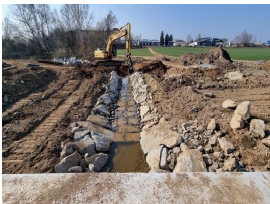
Obrázek 20 (vlevo): Průběh výstavby projektu Suchá nádrž Týnské předměstí Zdroj: (město Domažlice) – nepublikováno
