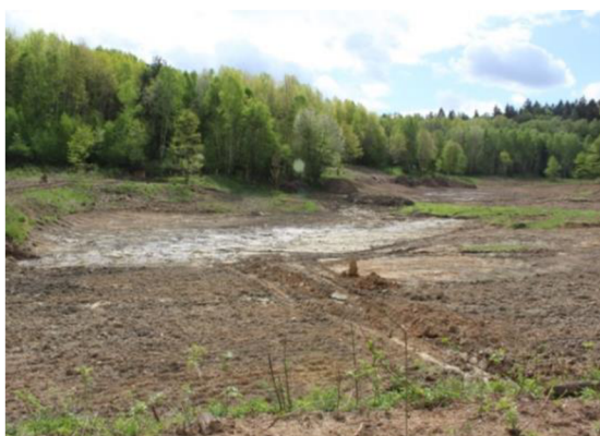
Obrázek 16 (vlevo): Průběh výstavby projektu Vodní nádrže Na cvičáku Zdroj: (město Domažlice – nepublikováno)
