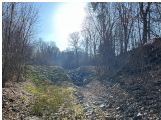
Obrázek 17: Současný stav protierozní rokle Zdroj: (pořízeno autorem)
