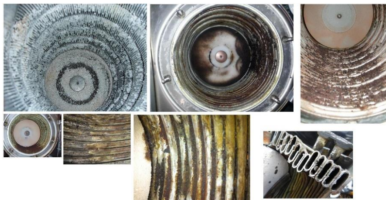
Obr. 10 Zanesený výměník tepla [11]
