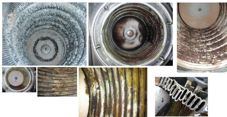
Obr. 10 Zanesený výměník tepla [11]
