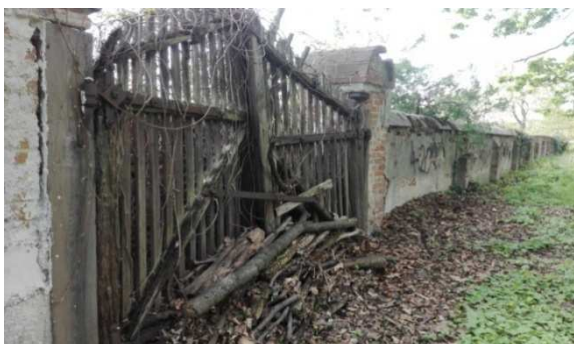
Obr 2 Múr v pôvodnom dezolátnom stave (foto: autor, 2017)
