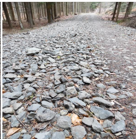
Obrázek 50: Lesní cesta „Parkoviště – Dučický dolík“ Porucha – rozebraná konstrukce vibrovaného štěrku, špatný postup lesní výroby (Veronika Rusová, 2017)
