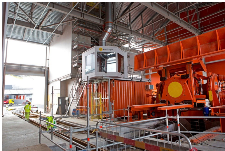
Obr. 1.4.2.3 Stacionární vykládací systém uvnitř objektu
