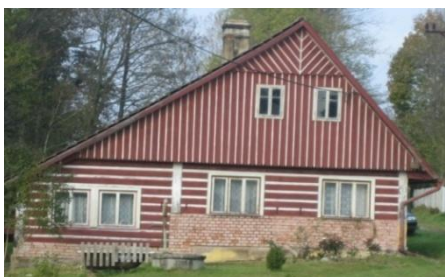
Obr. č. 192: Opravená podezdívka cihlami roubené chalupy, jež je narušena přístěnkem. Nevhodně půdobi také trojdílná okna. (foto: autor, 2011)
