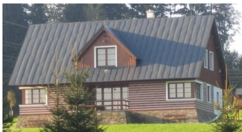
Obr. č. 231: Ukázka špatného provedení rohů stavby – průběh spár přes hranu by správně neměl být vidět. (foto: autor, 2011)
