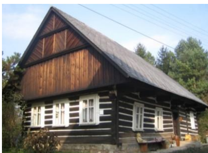
Obr. č. 189: Roubená chalupa, na které je vidět výrazná nerovnost stěn. (foto: autor, 2011)
