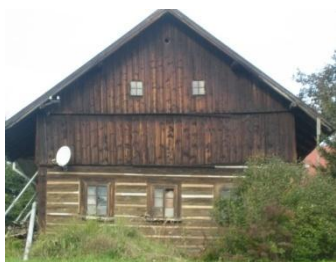
Obr. č. 193: Chalupa, která je dokladem chátrání některých roubených objektů. (foto: autor, 2011)
