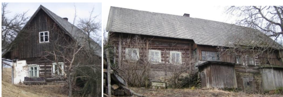
Obr. č. 17 a 18: Na další chalupě nacházející se ve vesnici Horní Štěpanice je vidět jak dochází k chátrání objektu. (foto: autor, 2011)
