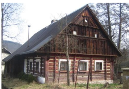
Obr. č. 132: Zdokumentování chátrající chalupy s typickými malými čtvercovými okny a stěnovými kleštinami. (foto: autor, 2012)
