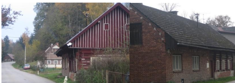
Obr. č. 204 a 205: Pohled na část zástavby na okraji Roztok u Jilemnice. Na chalupě v popředí na levé fotografii jsou vidět nevyplněné spáry mezi trámy. Dům celkově působí zanedbaně. (foto: autor, 2011)
