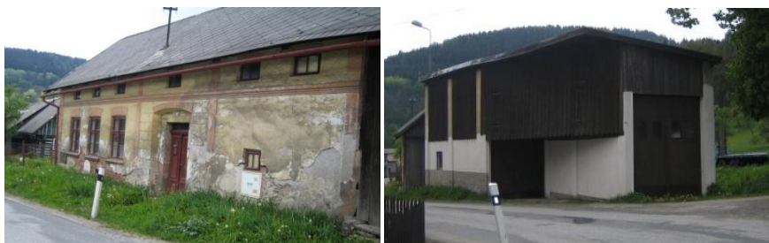
Obr. č. 68 a 69: Zděná stavba v chátrajícím stavu. Ke stavbě je připojena stodola, která byla zrekonstruována, aby mohla i nadále sloužit jako uskladňovací prostor. (foto: autor, 2011)
