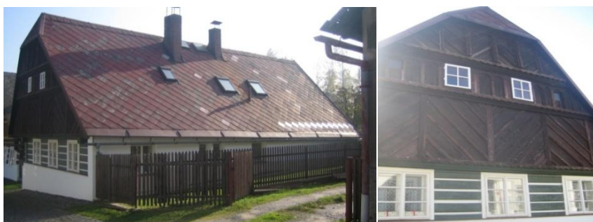
Obr. č. 123 a 124: Chalupa s lomenicí, jejíž bednění je ve spodním pruhu klasovitě uspořádáno. Negativně na stavbu podle mého názoru působí střešní okna. Jako u ostatních chalup je přední část chalupy roubená se světnicí a zadní díl je zděný. (foto: autor, 2011)
