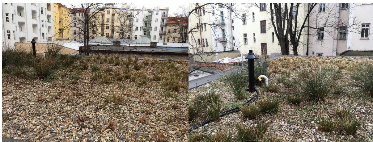
Obrázek č. 23. a 24.: Kořenová čistička na střeše – Praha Holešovice, (foto: vlastní)
