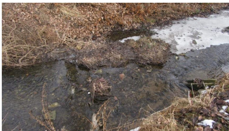
Obr. 6.4 Nánosy na úseku koryta v ř. km 1,600 – 1,695
