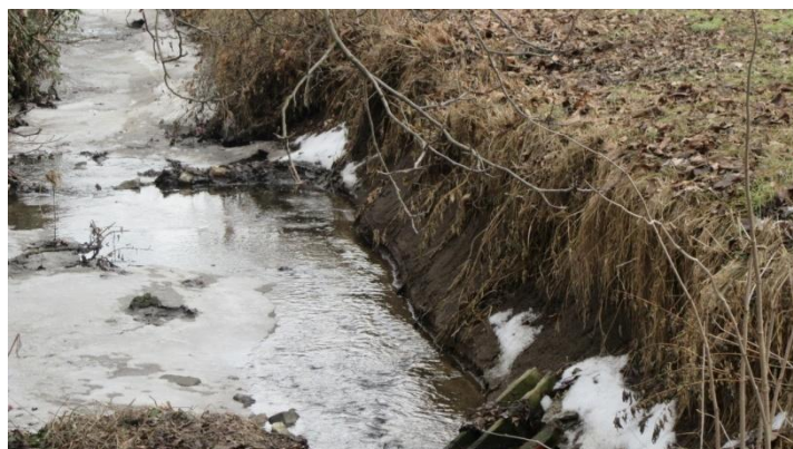
Obr. 6.5 Výmoly na úseku koryta v ř. km 1,600 – 1,695
