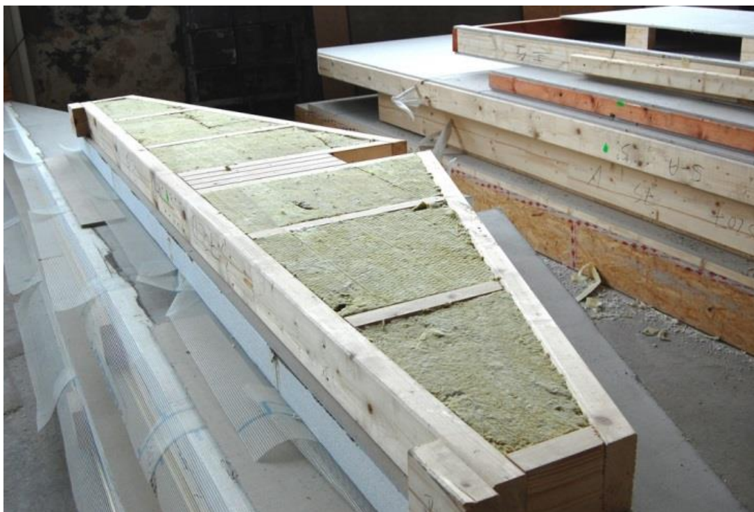
Obr. 2 Výroba stěnového panelu pro rámovou dřevostavbu: dřevěný rám sestavený na ploše, vkládání izolace mezi stojky ( www.tzb-info.cz )
