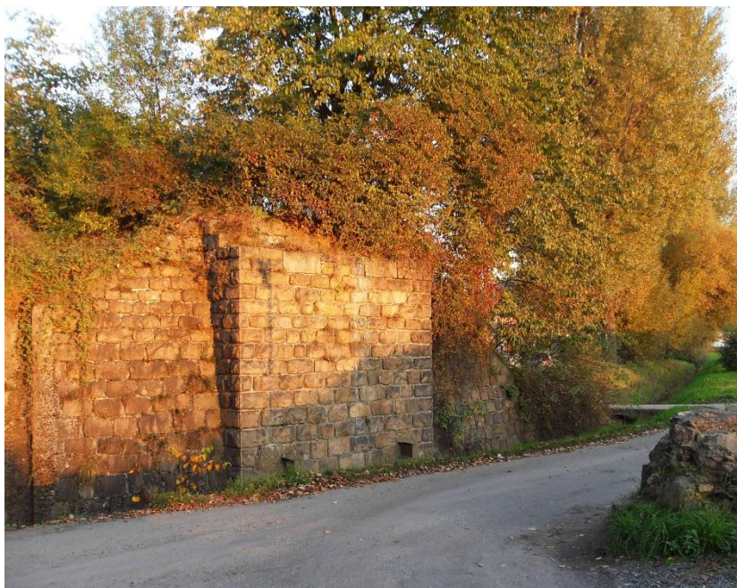
Obr. 7 Zbytek pilíře mostu v Kuřimi (zdroj: Michal Jandík)
