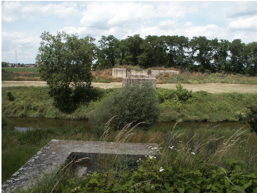
Obr. 15 Pilíře zbylé po bývalém mostě přes Dyji (zdroj: obec Hevlín)
