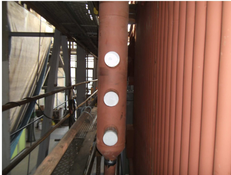
Obr. 15 Hlavní zavodňovací potrubí
