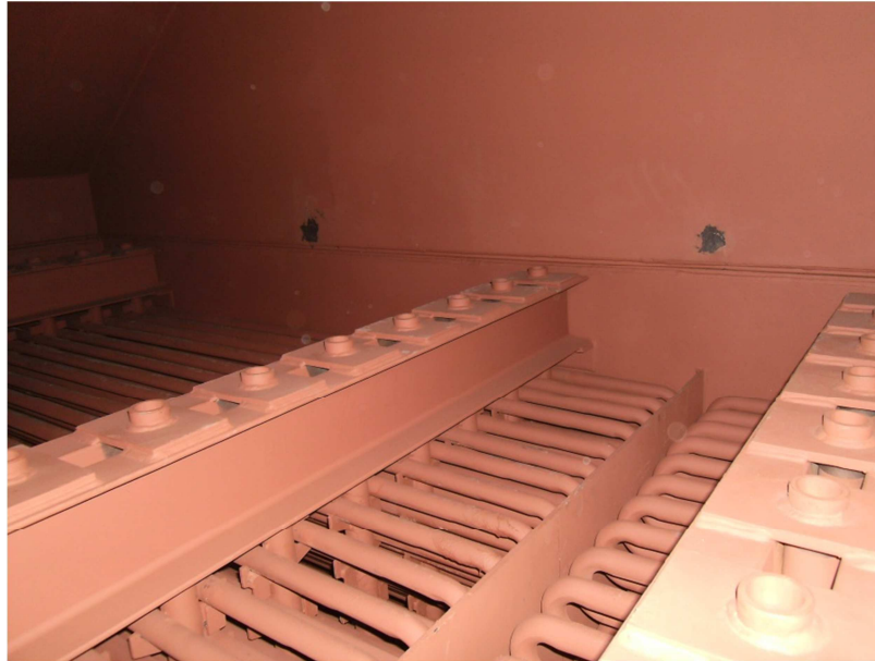
Obr. 12 Trubky ohříváku vody
