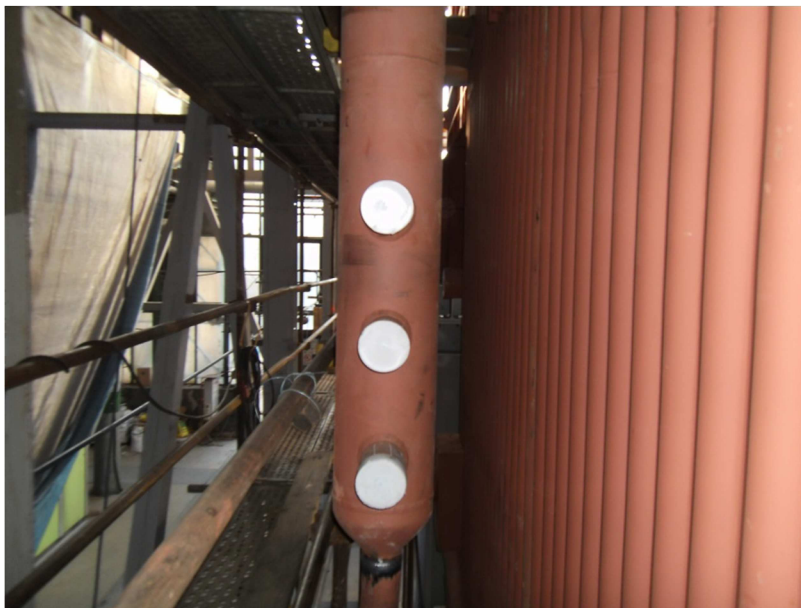
Obr. 15 Hlavní zavodňovací potrubí
