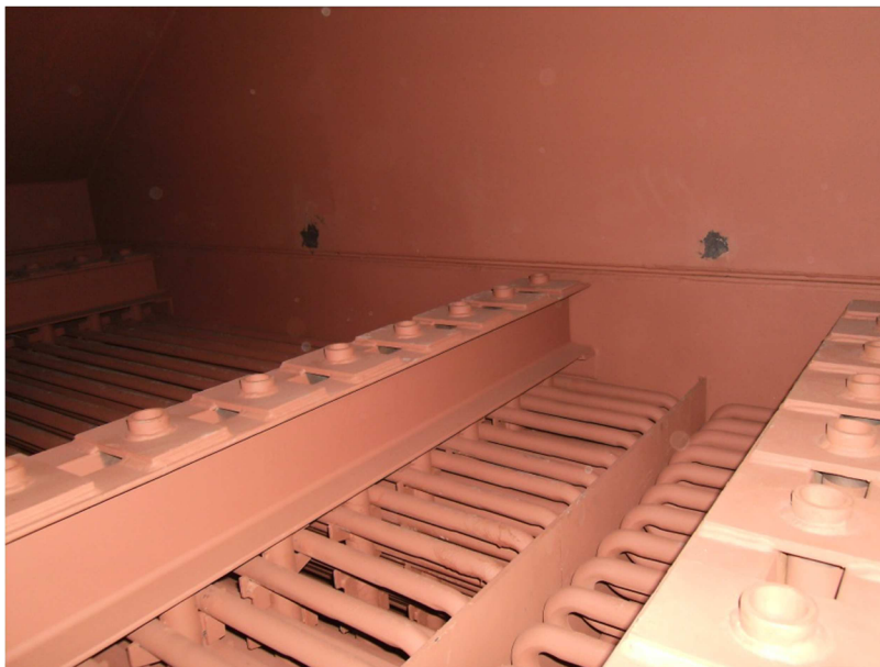
Obr. 12 Trubky ohříváku vody
