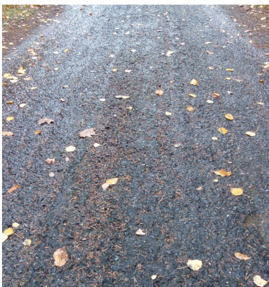
Obrázek 4 – Porušená obrusná vrstva na lesní cestě s asfaltobetonovým krytem
