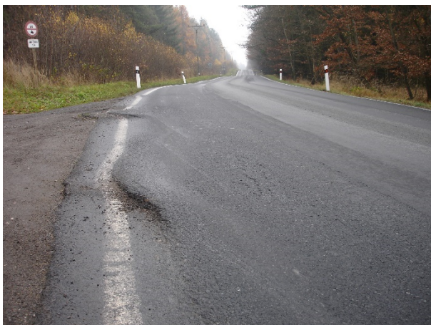
Obrázek 9 – Trvalé deformace na asfaltobetonovém krytu vozovky
