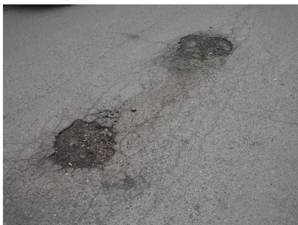
Obrázek 7 – Výtluky na asfaltobetonovém krytu vozovky
