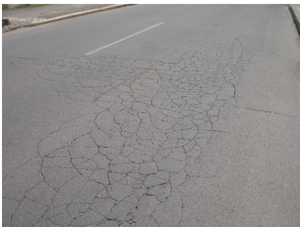
Obrázek 8 – Síťové trhliny na asfaltobetonovém krytu vozovky
