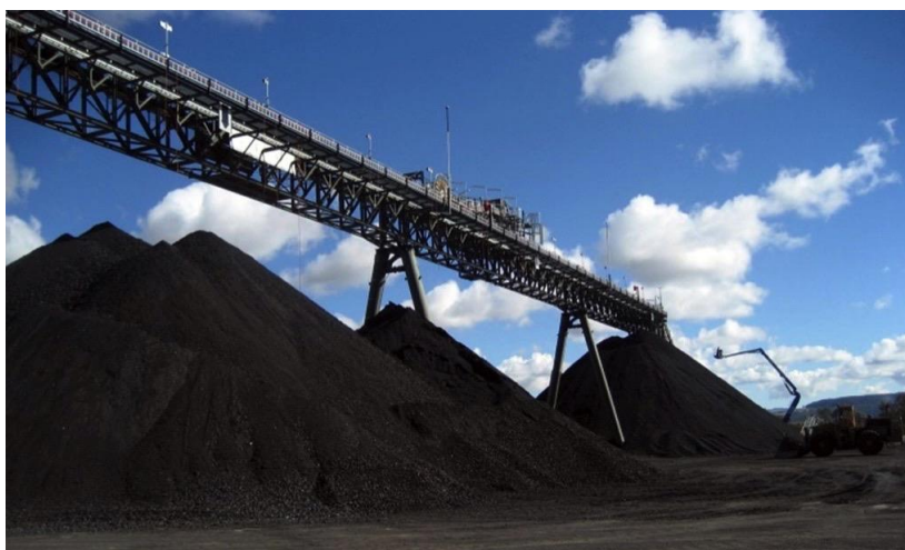
Obr. 5 Příklad nosné konstrukce pásového dopravníku
