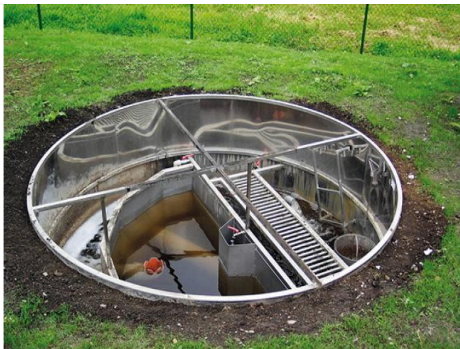
Obr. 6: Domovní čistírna odpadních vod (Idnes, 2012).
