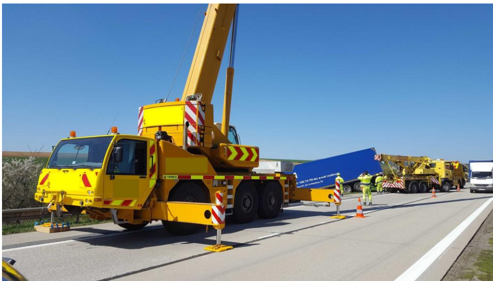
Obrázek 13- Dálnice D1 vyprošťování kamionu pomocí jeřábu DEMAG (1)
