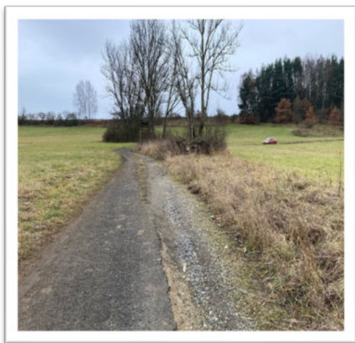
Obrázek č. 46 - VPC 1 poškozený úsek (autorka)
