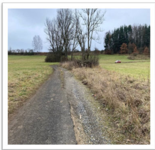
Obrázek č. 46 - VPC 1 poškozený úsek (autorka)
