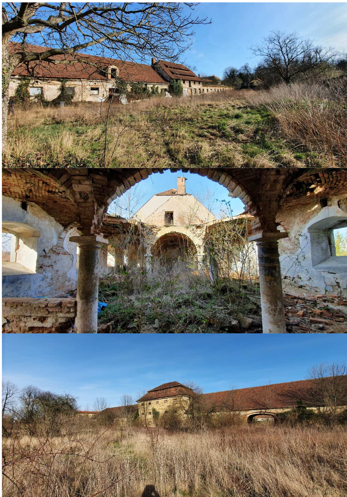
Obr. č. 18: Fotodokumentace současného stavu levého křídla: 1. jihovýchodní pohled na zdevastovanou konírnu; 2. vnitřní prostor objektu; 3. severovýchodní pohled na stodoly se sýpkou (autor Filsaková 2020).
