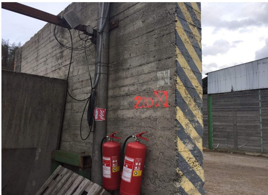
Obr. 4. 1 Zaznačení místa pro montáž přívodu elektrické energie napájecího radarový systém řízení dopravy v rizikové oblasti
