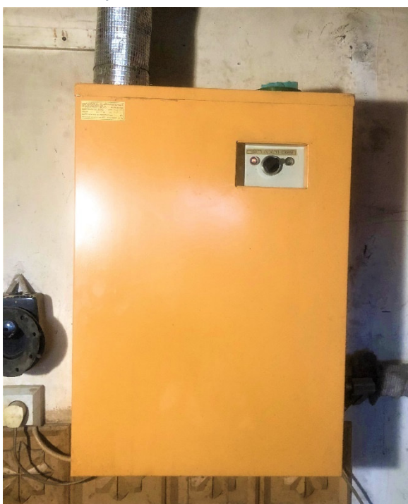
Obr. 32 Stávající elektrokotel DUKO
