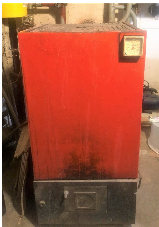
Obr. 31 Stávající kotel na tuhá paliva DAKON URS-24
