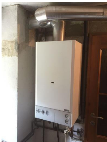
Obr. 8.3 Stávající plynový kotel
