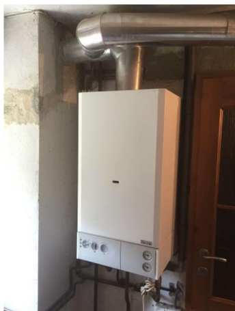
Obr. 8.3 Stávající plynový kotel
