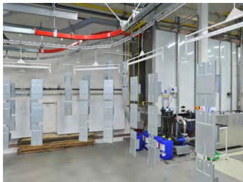
(a) Závěsný dopravník na vstupu do odmašťovací komory.
