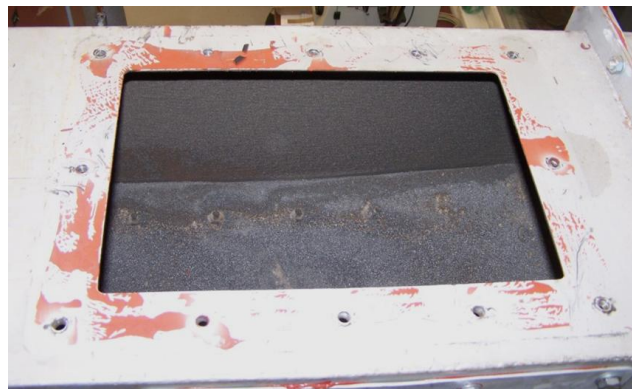
Obr. 29 Otvor v kouřovodu pro TEG
