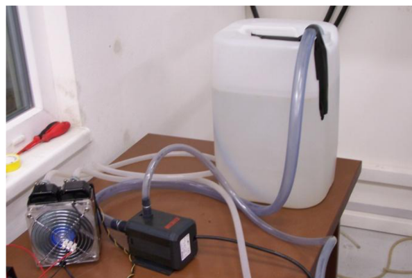
Obr. 31 Plastová nádrž, čerpadlo, pomocný ventilátor
