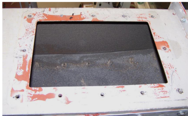
Obr. 29 Otvor v kouřovodu pro TEG
